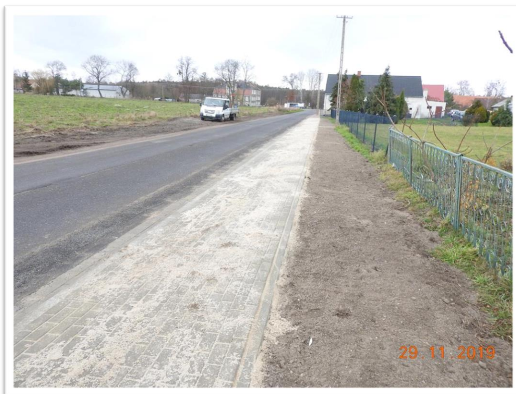
Fot. Chodnik przy drodze powiatowej w miejscowości Gronowice
